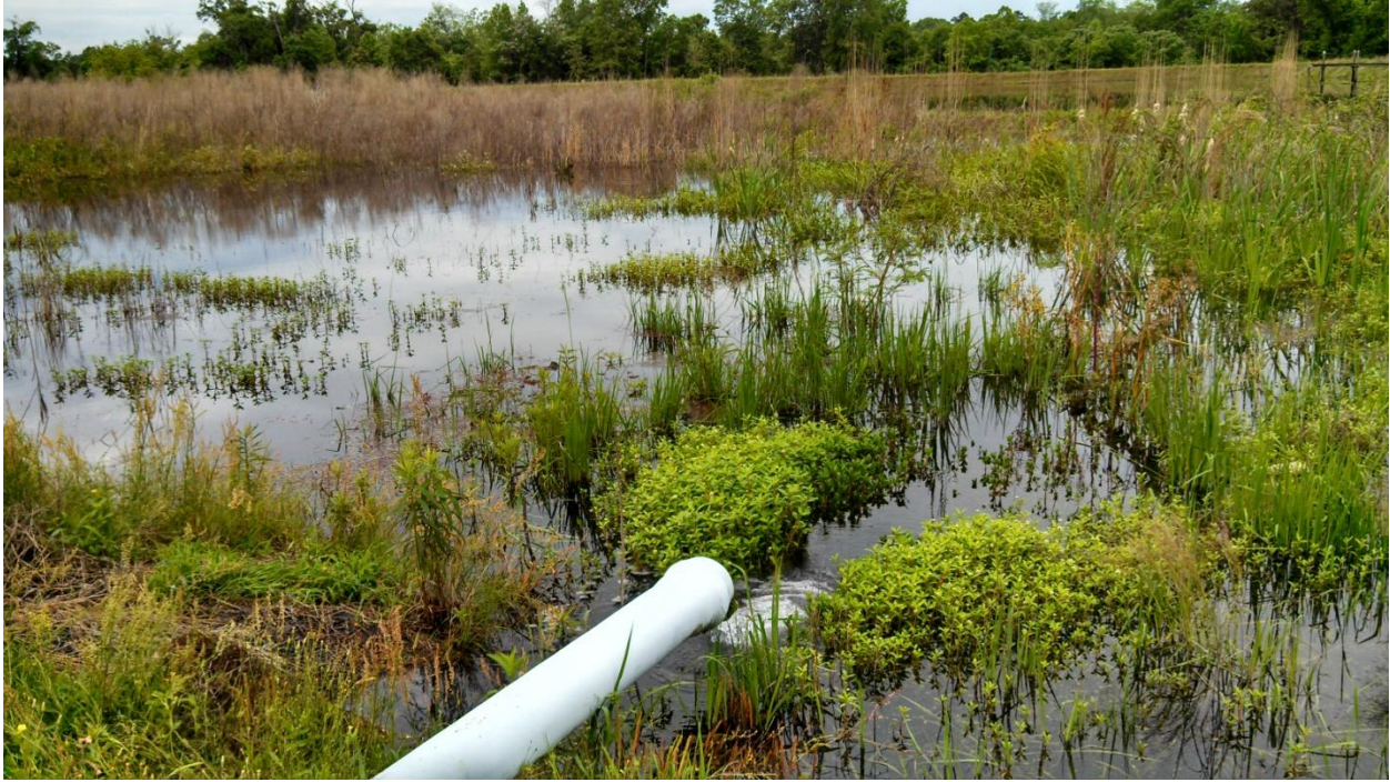
PHOTO 28 8" PVC SLURRY DISCHARGE PIPE
